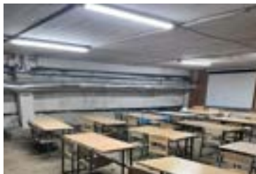
Lampen für das „Bunker“-Gymnasium Nr. 1“ in Putivl; Foto: IGFM Ukraine
